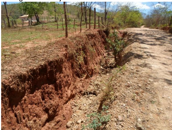
Foto 9: Erosão no bordo da estrada observada na Micro Bacia do Córrego Galho Grande. – 07/10/16
