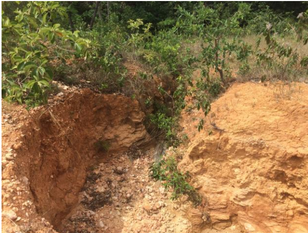
Foto 13: Ravina observada na Micro Bacia do córrego Galho Grande. – 07/10/16
