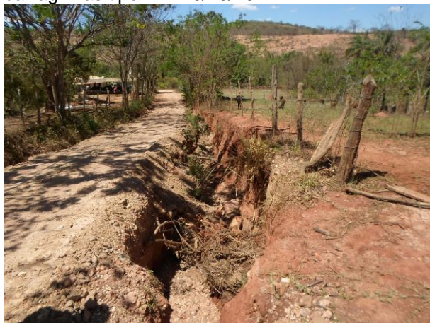
Foto 10: Erosão no bordo da estrada observada na Micro Bacia do Córrego Galho Grande. – 07/10/16
