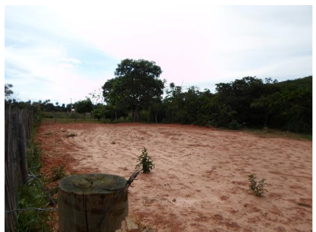
Foto 18: Registro de terraplenagem atingindo a APP do córrego Soberbo. – 16/11/16
